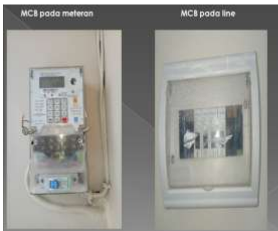
Gambar 12. Main Contact Breaker (MCB) yang terdapat pada dalam rumah (MCB LINE)
