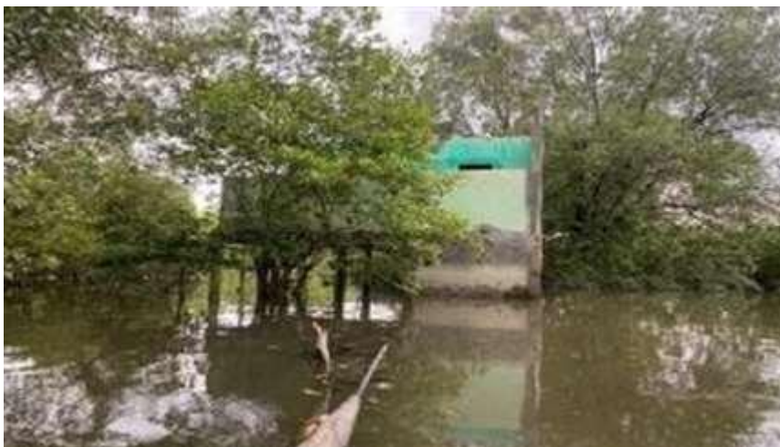
Keterangan: Fasilitas ekowisata (toilet) sudah rusak
