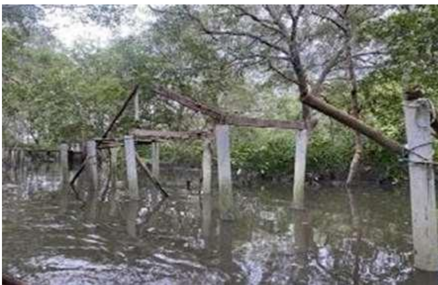
Keterangan: Fasilitas ekowisata (jembatan) yang sudah rusak
