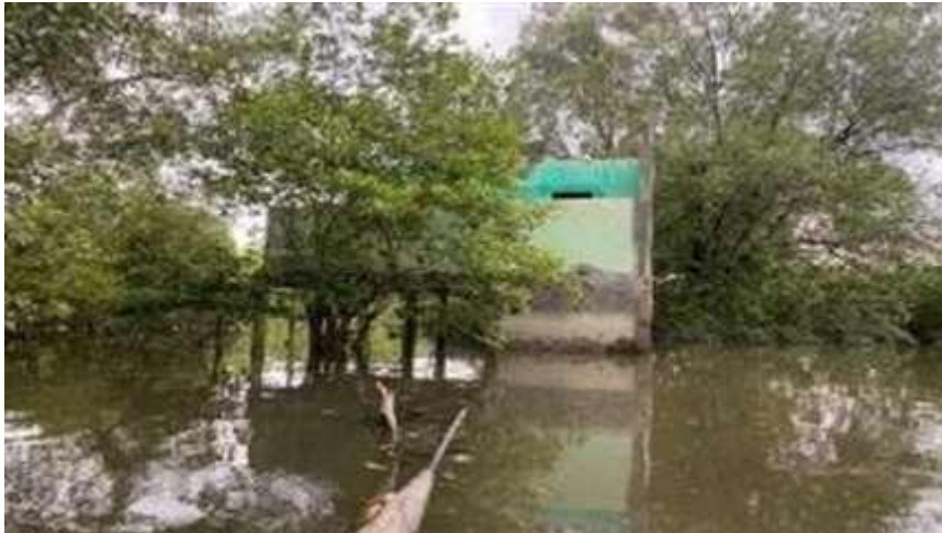
Fasilitas ekowisata (toilet) sudah rusak
