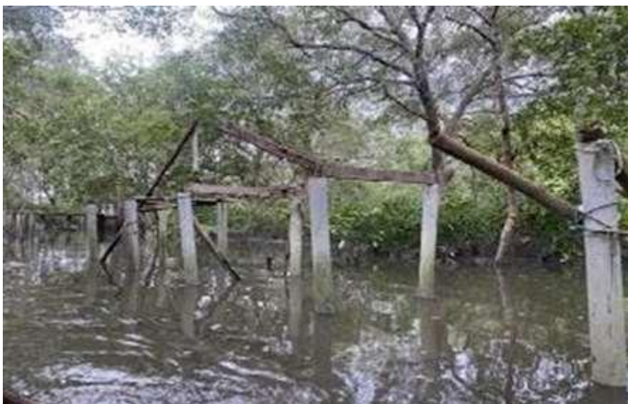
Fasilitas ekowisata (jembatan) yang sudah rusak
