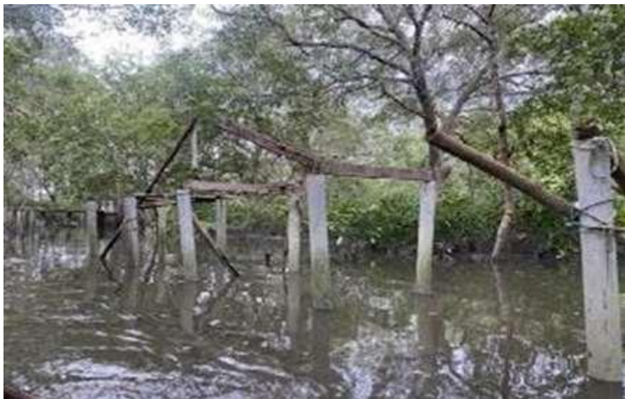
Fasilitas ekowisata (jembatan) yang sudah rusak
